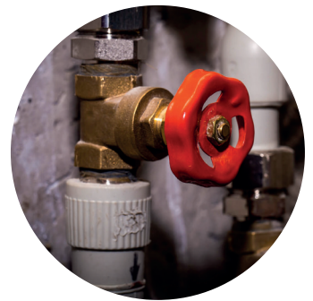
podłączenie do wody z sieci
